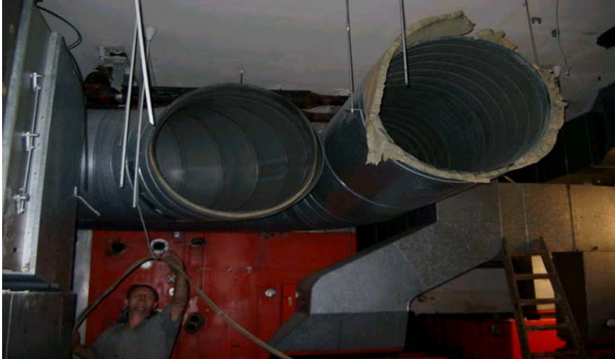
Abbildung 4.4: Lüftungsrohre mit eingebauter Isolation.
